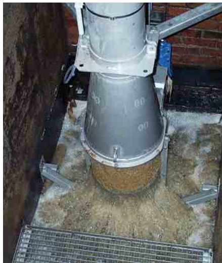
DIE SIEBANLAGE: Bild 5 Sie hält Störstoffe über 3 mm Durchmesser aus dem Abwasserstrom zurück.
