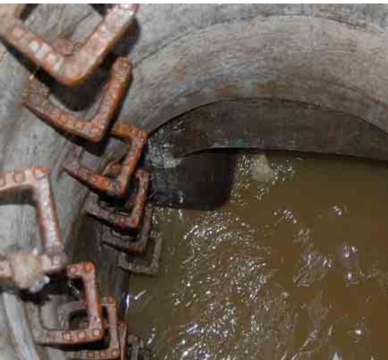
WICHTIGE VORAUSSETZUNG: Bild 3 Der zur Wärmeenergienutzung angezapfte Hauptsammler hat einen konstant hohen Trockenwetterabfluss.
